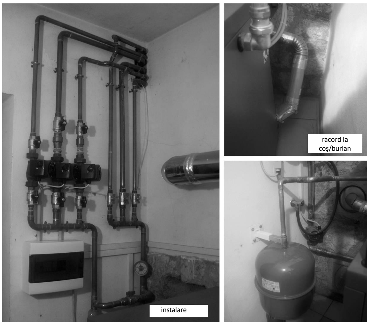
Figura 14: Exemplu de centrală termică
