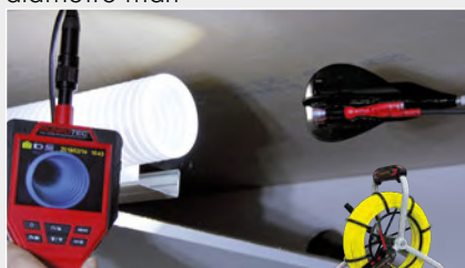
Inspectie ventilatie si intretinere
